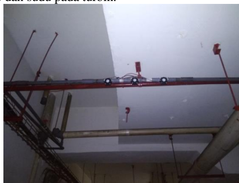
Gambar 2 Pipa Pvc yang terpasang turbin
