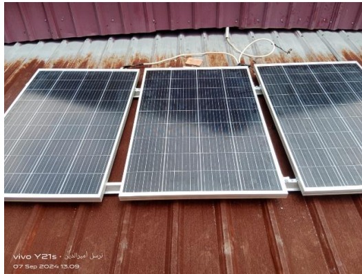
Gambar 4. Panel Surya yang terpasang di atap Sekolah
